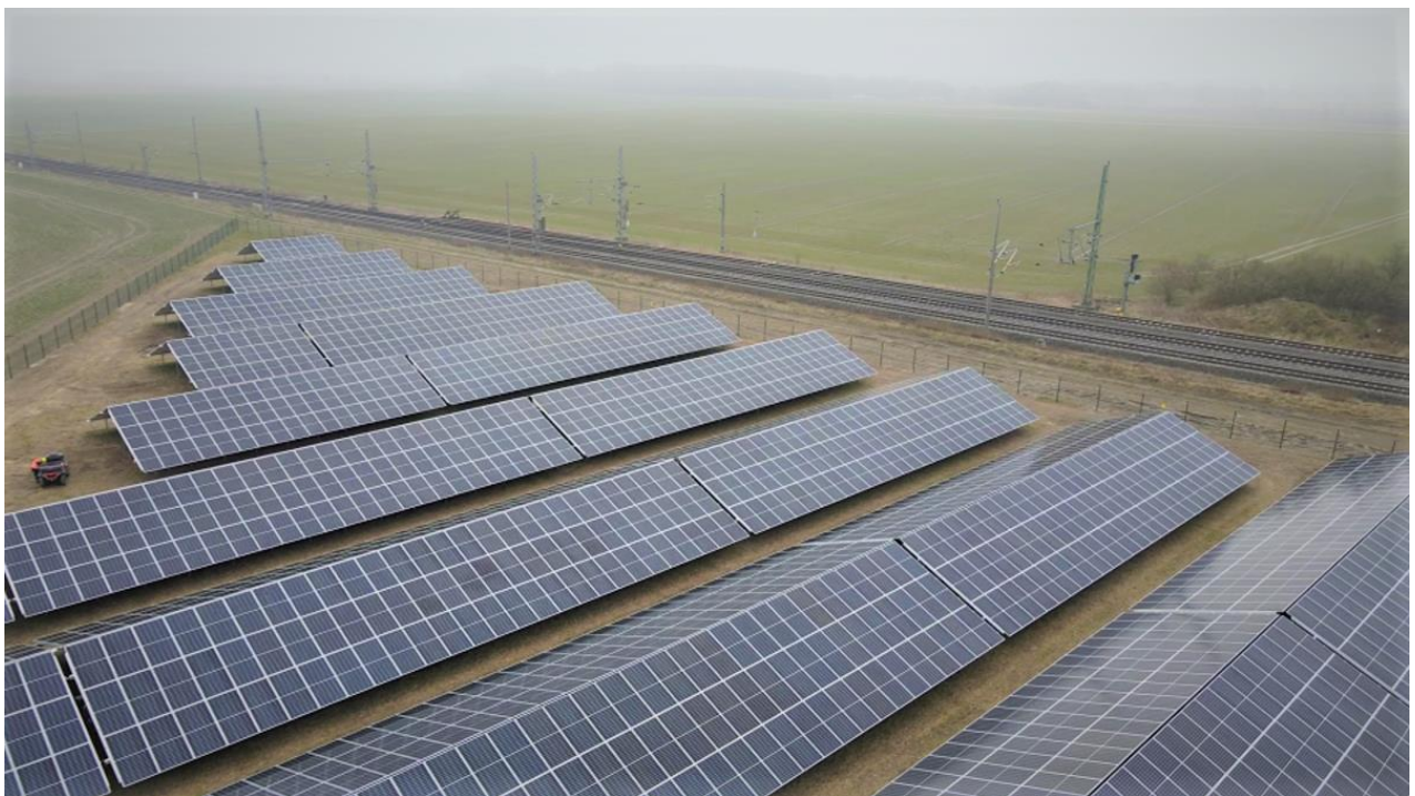
Abbildung 3: Photovoltaikfreiflächenanlage in Ost-West-Ausrichtung
